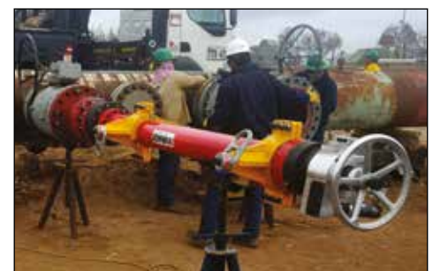
▲ Aplicación de hot tapping con CHT3000 para la instalación de oleoductos petroquímicos.
